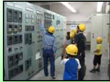
（発電所の内部）
