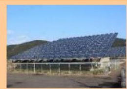
再エネ発電設備
