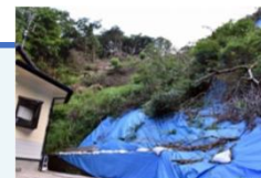
豪雨の度に 土砂崩れが多発
