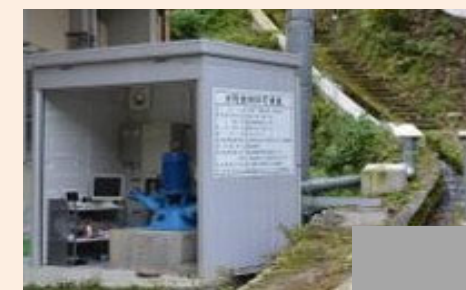
小水力発電設備
