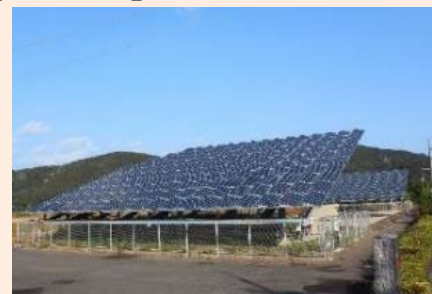
太陽光発電設備
