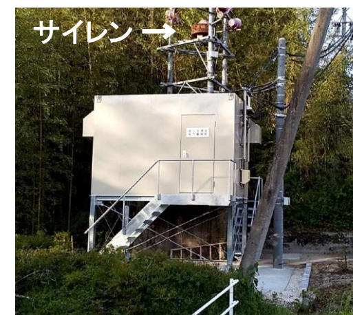
放流警報装置 （ダム下流23局）
