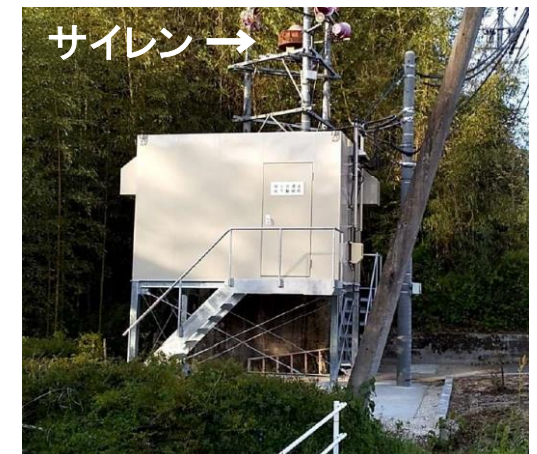
放流警報装置 （ダム下流23局）
