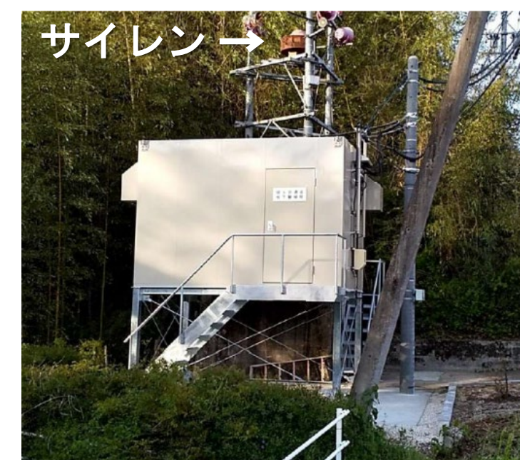
放流警報装置 （ダム下流23局）
