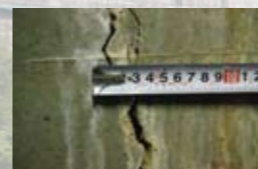
コンクリートのひび割れ状況を確認しました。
