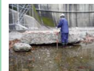
破損したコンクリート塊。（長さ3.5m×幅2.0m×厚さ0.7m）
