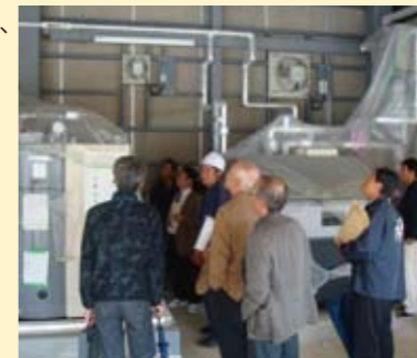
「なごみの里」の薪ボイラー施設
