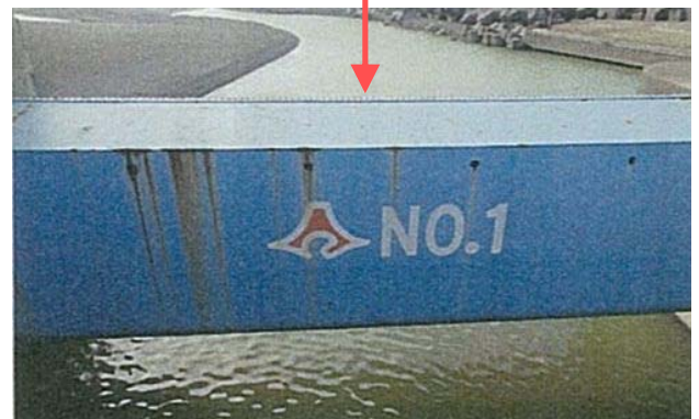
①上屋が過度な装飾となっている事例 ②青色に塗った水門によって周辺景観との調和していない事例
