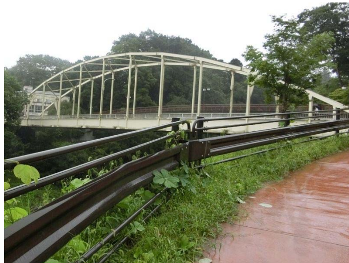
橋梁の形式・色彩が周辺環境と調和していない事例
