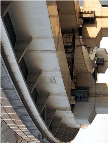
写真 1-8 経年変化による退色や表面の劣化に配慮する必要がある
