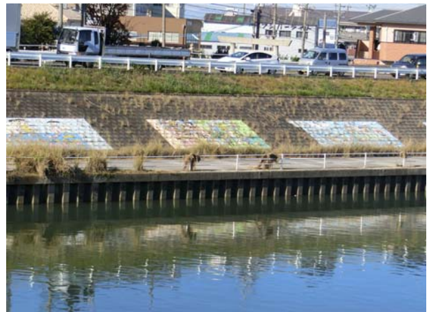
護岸の装飾の意味がわかりにくく、その必要性について検討すべき事例
