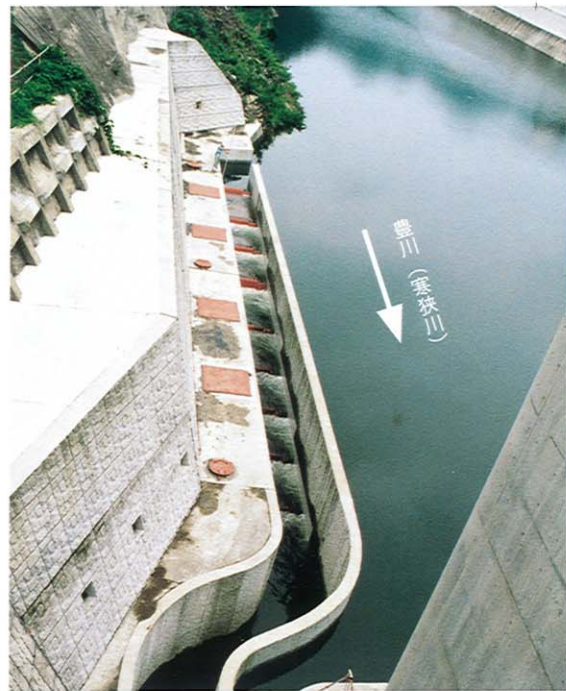
魚道 放流口 フラップゲート→
