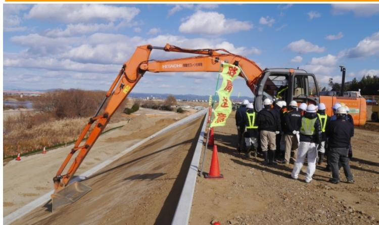
モニターで設計値とバケットの水平角度等を見ながら法面整形
