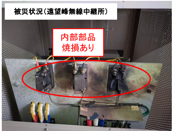
被災状況(遠望峰無線中継所) 内部部品 焼損あり 耐雷トランス盤(30kVA)の破損
