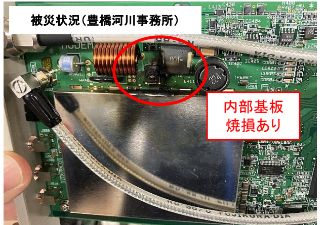
被災状況(豊橋河川事務所) 内部基板 焼損あり 多重無線装置の破損
