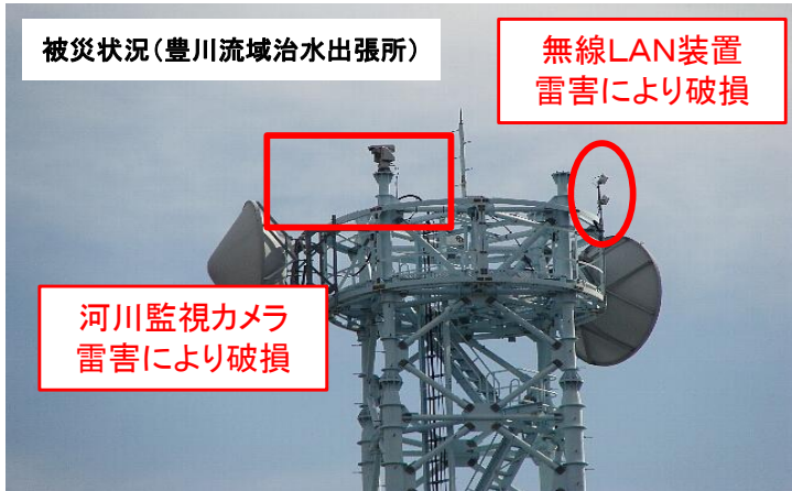
被災状況(豊川流域治水出張所) 無線LAN装置 雷害により破損 河川監視カメラ 雷害により破損 河川監視カメラ・無線通信装置の破損
