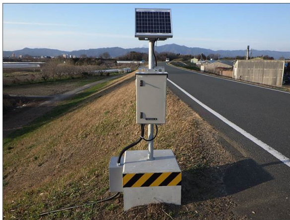
危機管理型水位計の外観
