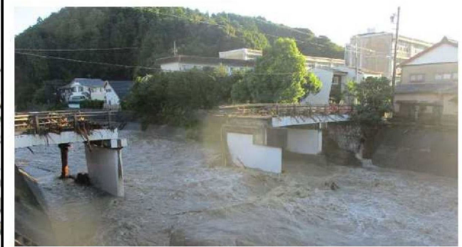
はままつし しょうげつばし 静岡県浜松市道(嘯月橋の一部損壊)
