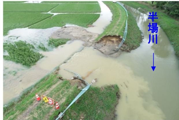
ドローンによる被災状況調査
