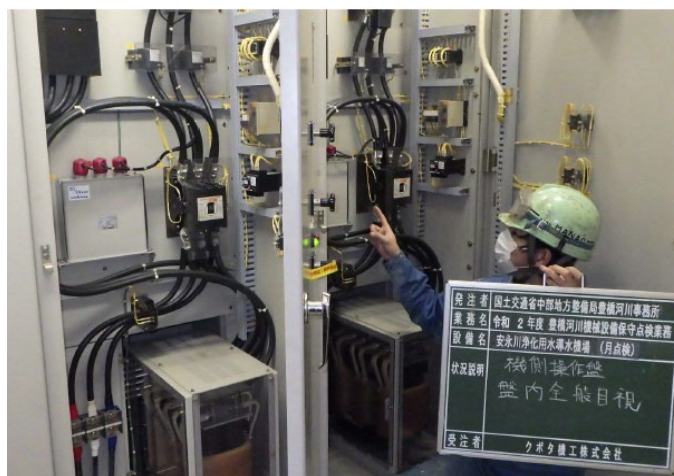
ポンプ設備の点検
