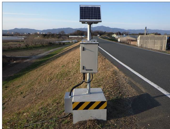
危機管理型水位計の外観
