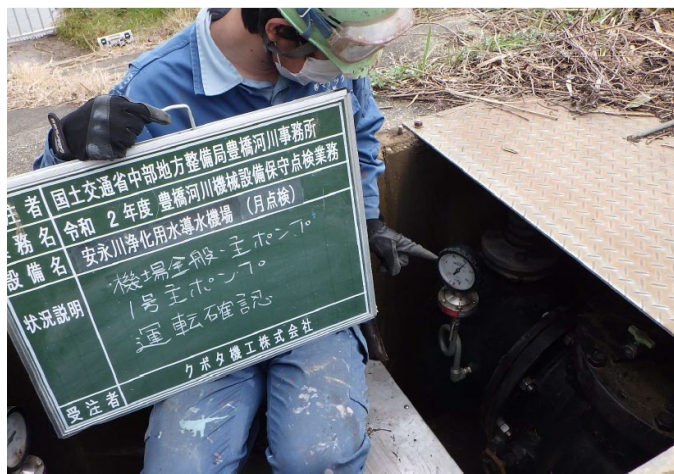
ポンプ設備の点検
