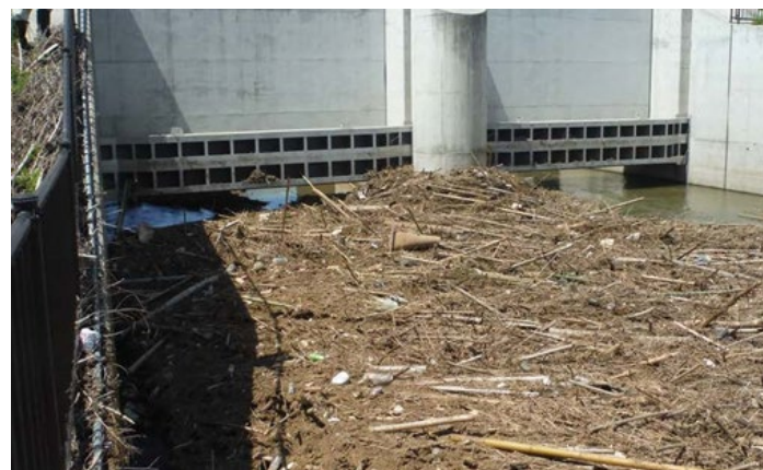
堰（堰堤）流入部に堆積した流木
