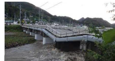
国道20号 山梨県大月市 法雲寺橋 (橋梁下部工洗掘)
