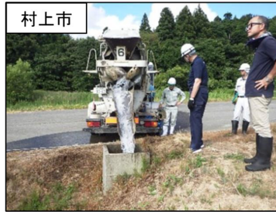
農業用水路への給水状況
