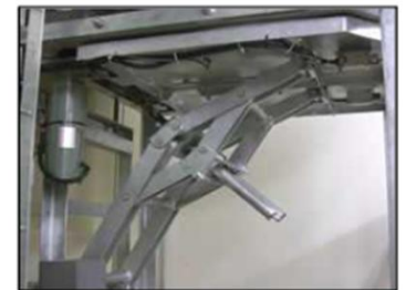
換気口浸水防止機
