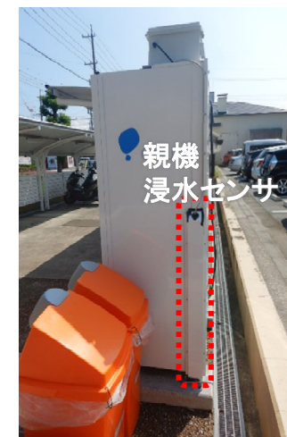
<自動販売機側 浸水センサ 1段>
