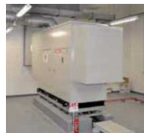
非常用発電設備のイメージ
