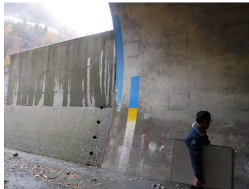
流れた土砂や石により削られた塗装
