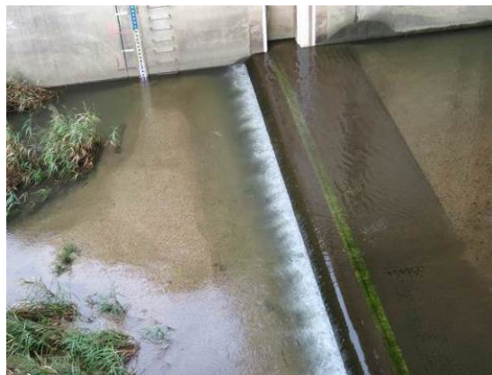
図 1 加茂川水門の段差状況
