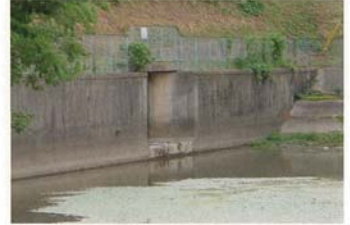
③承水溝—長池の段差（承水溝側）
