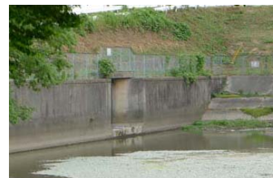
長池ー承水溝の段差
