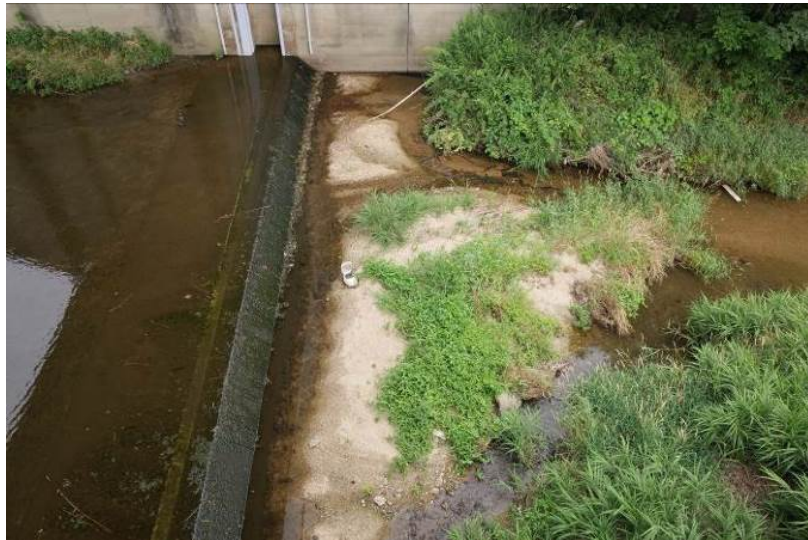
図 1 加茂川合流点段差の状況
