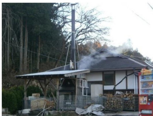
薪ボイラーを活用する花白温泉
