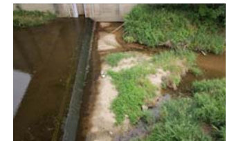
加茂川合流点段差の状況
