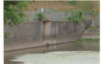
③承水溝-長池の段差（承水溝側）
