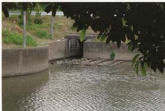
①家下川-承水溝の段差
