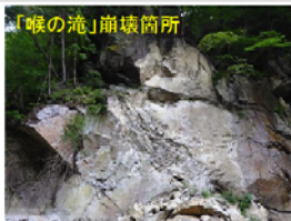
「喉の滝」崩壊箇所
