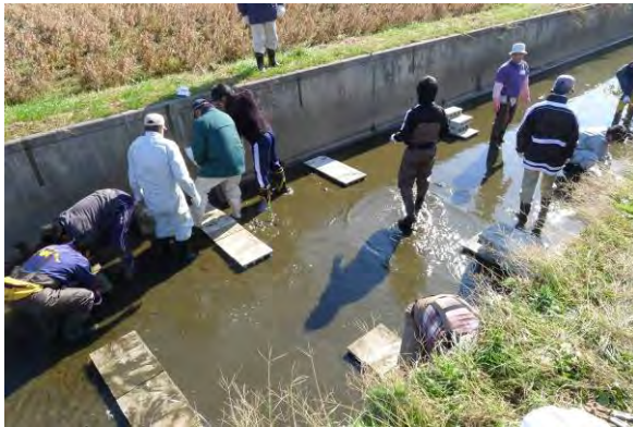
コンクリートブロック設置状況 (家下川リバーキーパーズの活動)
