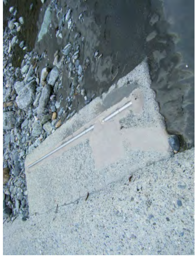
砂防ダムに設置された ハイドロフォン⇒流砂量観測
