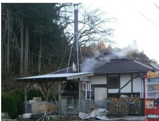
薪ボイラーを活用する花白温泉
