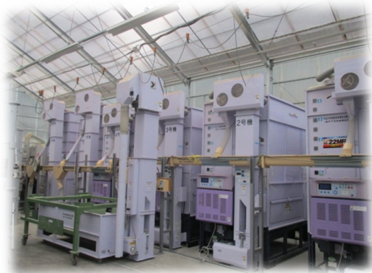
写真5 乾燥・粃摺り・袋詰め一貫プラント棟
