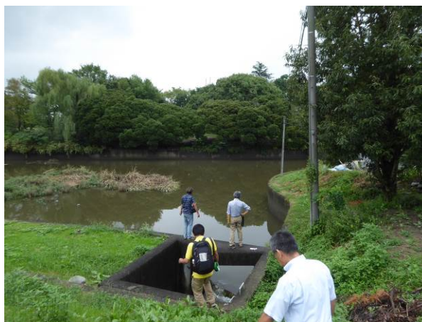
図 7 ひょうたん池周辺の段差確認
