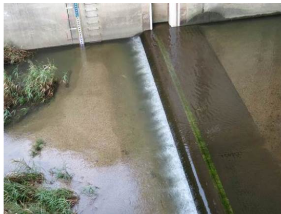
図 1 加茂川水門の段差状況
