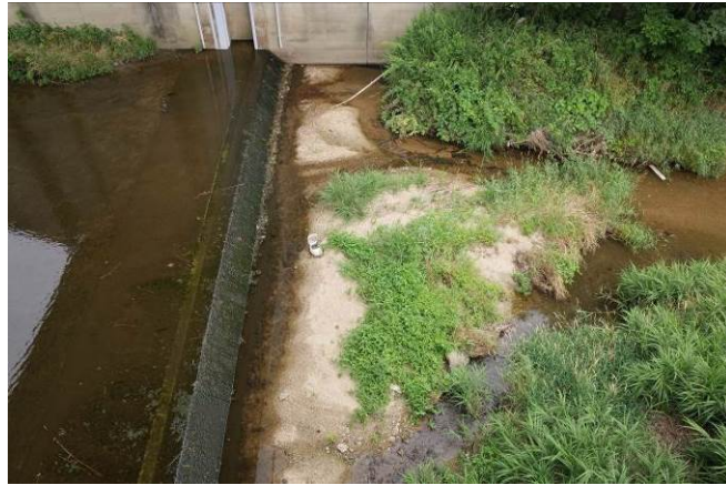
図 1 加茂川合流点段差の状況
