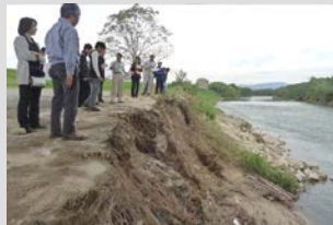
高橋右岸付近の被災の様子 （河岸が削られている）
