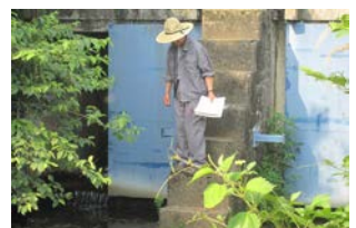
大見川合流部の段差の状況
