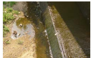
加茂川水門下の段差の状況
