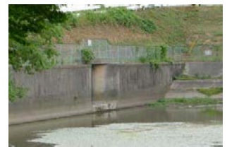
長池一承水溝の段差
