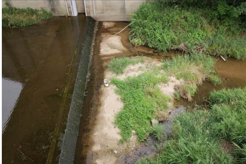
図 1 加茂川合流点段差の状況
