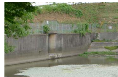
長池一承水溝の段差
