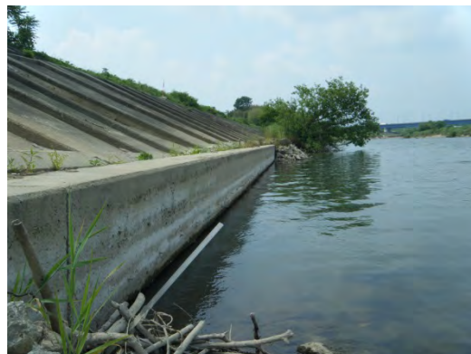
■ 既設護岸被災状況
