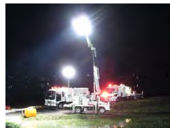
■洪水時における支援状況 (排水ポンプ車・照明車による排水作業 愛知県幸田町 広田川 平成20年8月)
