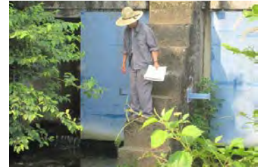
大見川合流部の段差の状況
