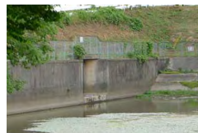
長池ー承水溝の段差
