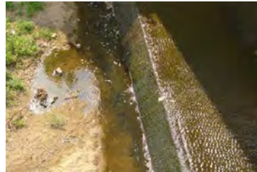
加茂川水門の段差の状況
