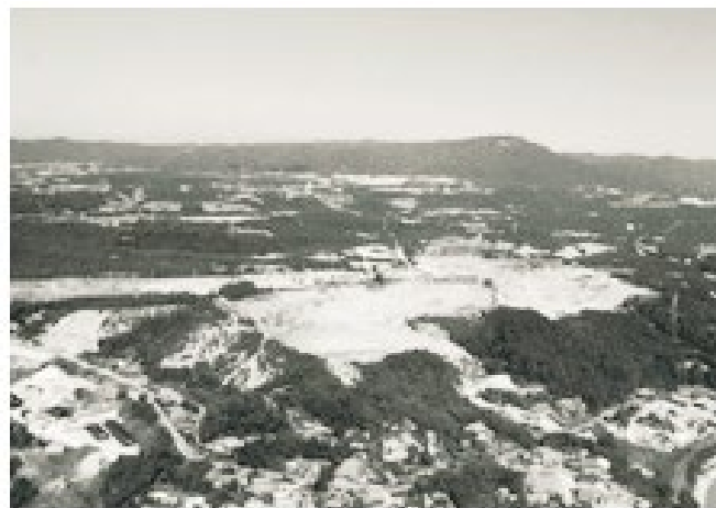
宅地やゴルフ場の造成などの乱開発現場
