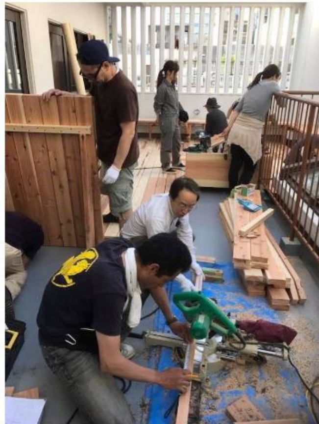
スペインバル・ハヤシの屋上テラスを木質化。材料費はオーナーが負担し、地元の建築家が設計、プロジェクトメンバーが汗を流した（都市の木質化プロジェクトFacebookより）
