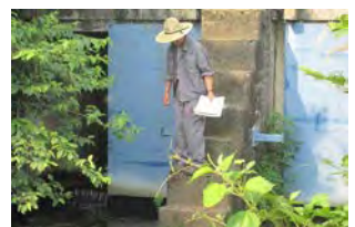
大見川合流部の段差の状況
