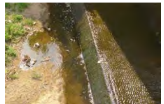
加茂川水門下の段差の状況
