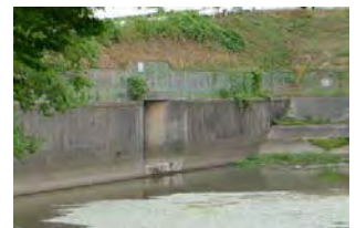
長池一承水溝の段差
