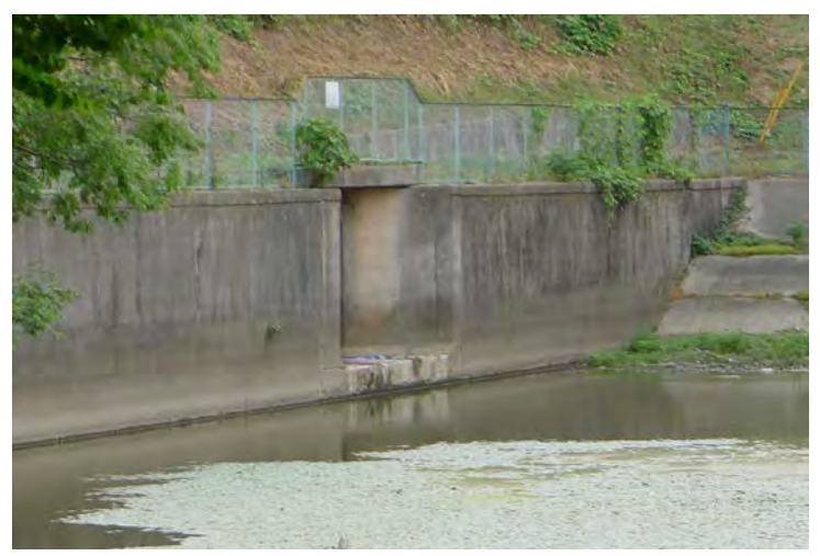
③承水溝－長池の段差（承水溝側）
