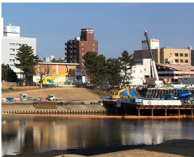
建設の進む将来の人道橋付近の様子 殿橋より乙川上流をのぞむ（2018年1月16日）
