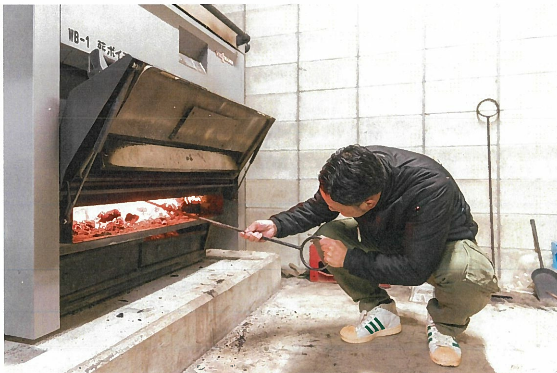
役場全体をあたためる薪ボイラー。根羽村振興課 片桐充貴さんいわく、燃料はすべて根羽村の材で、根羽村が薪ボイラー用の新材を地域通貨券で買い取り、高齢者福祉施設などで活用。今まで捨てていた木材が収入源になり、エネルギーの地産地消につながっている。
