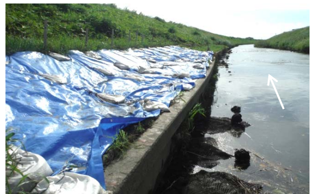
災害発生状況
