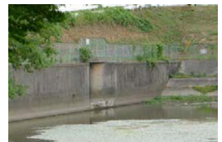
長池一承水溝の段差
