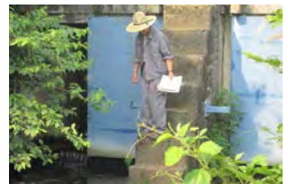
大見川合流部の段差の状況
