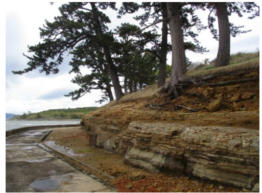
写真 38 道路沿い崖 (風雨侵食で後退)
